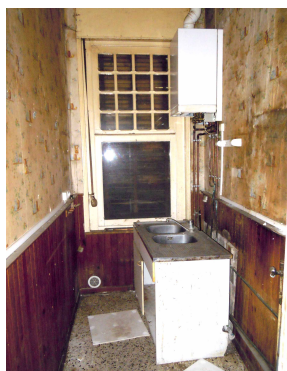
Non décent (avant travaux)
