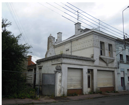
Non décent (avant travaux)
